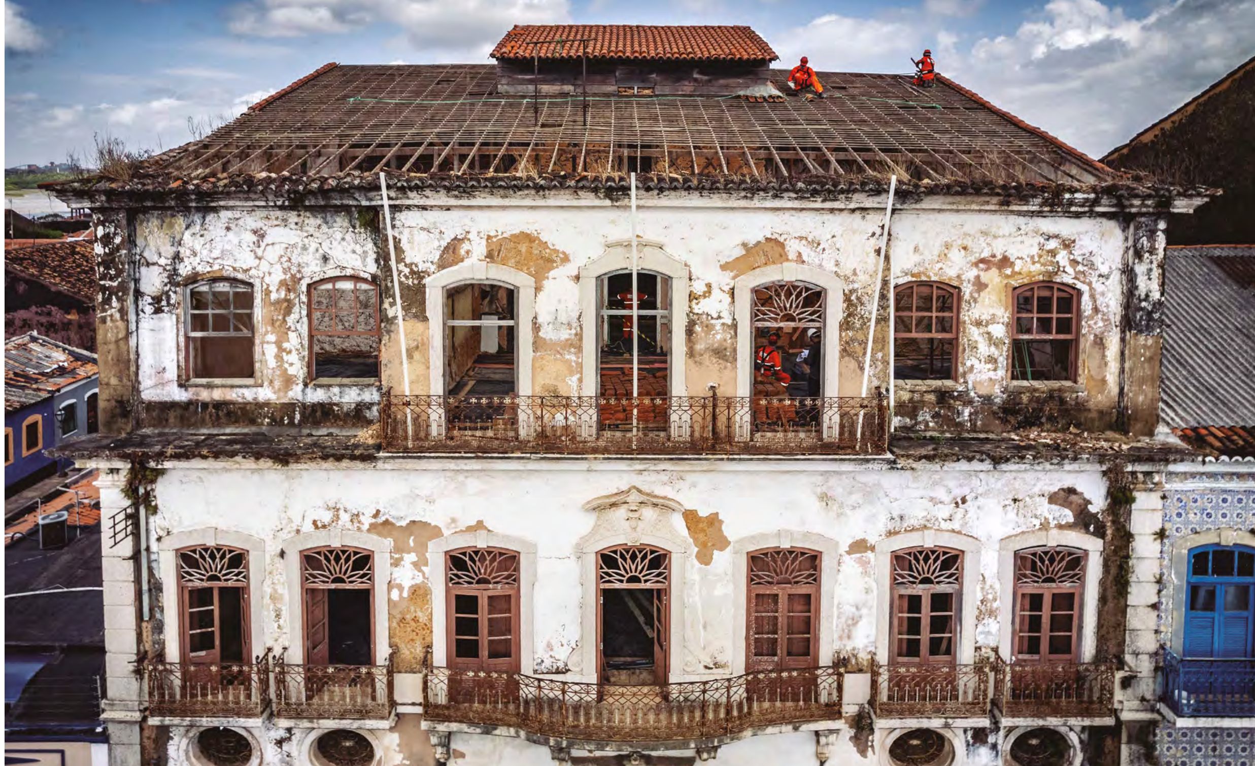
Imagem externa da fachada do Palacete da Rua Formosa antes das obras de restauro Foto Albani Ramos/Acervo Instituto Pedra
