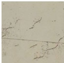
13 / TRINCA E FISSURA
