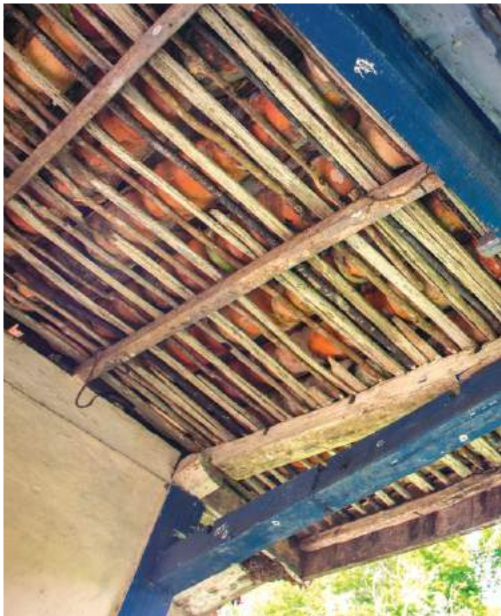
FIG. 142 Ripamento da cobertura de edificação rural, Monsenhor Horta. Foto dos autores, 2022.
