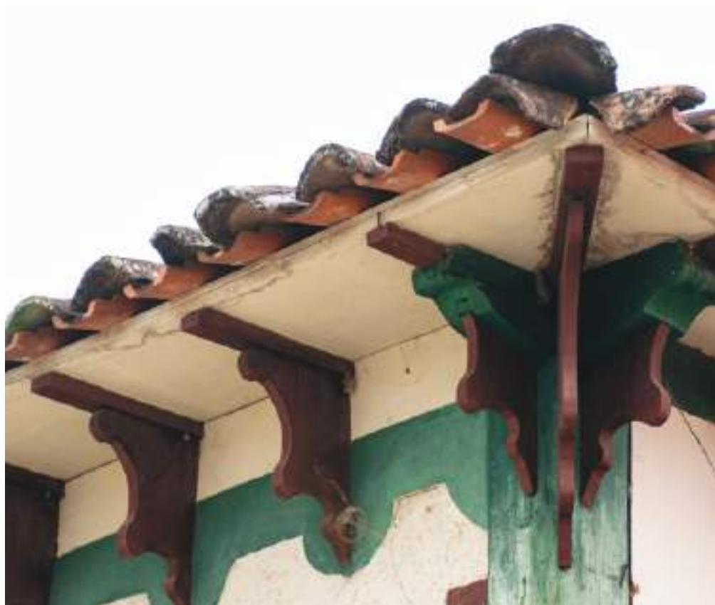
FIG. 154 Mão-francesa do beiral do telhado de edificação civil, Furquim. Foto dos autores, 2022.
