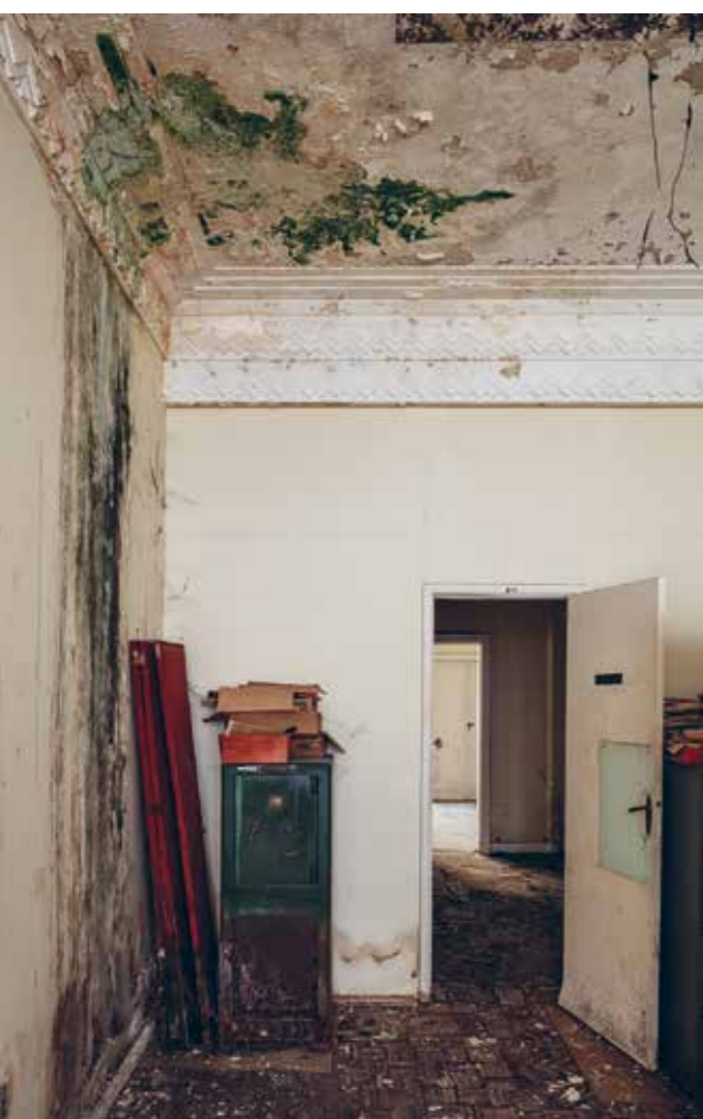
Edifício Niterói, patologias
