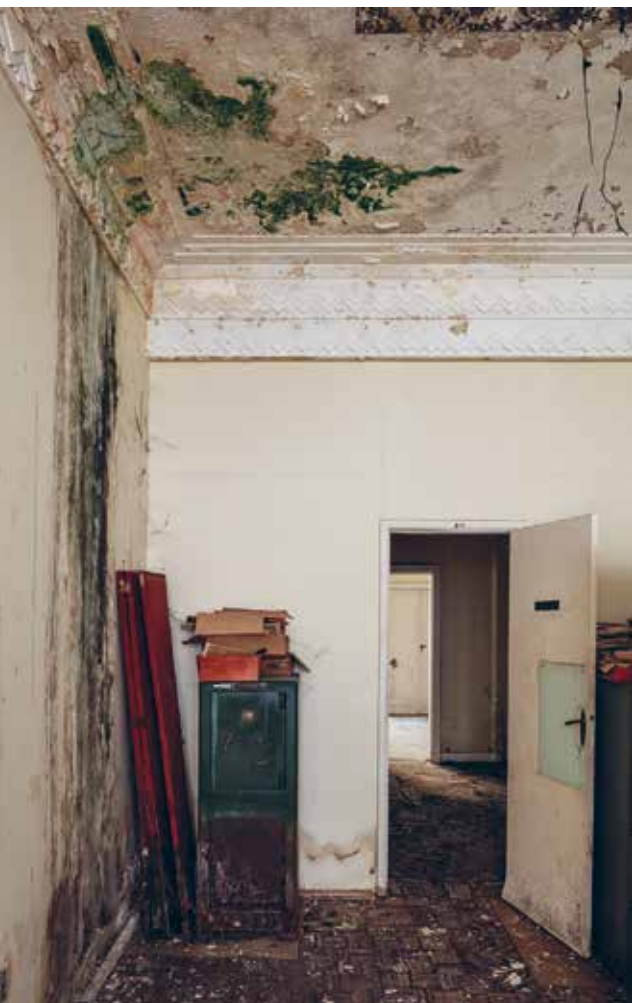
Edifício Niterói, patologias
